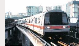
シンガポール地下鉄・MRT、シールド工事の巻込み養生・防護壁
